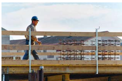
Apertura pericolosa sul cassero per soletta (ad es. in caso di interruzioni nel getto di calcestruzzo)
