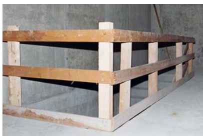
Apertura pericolosa nella costruzione grezza interna (ad es. apertura per le scale)
