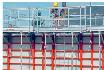
Apertura pericolosa su una piattaforma di lavoro per il getto di calcestruzzo
