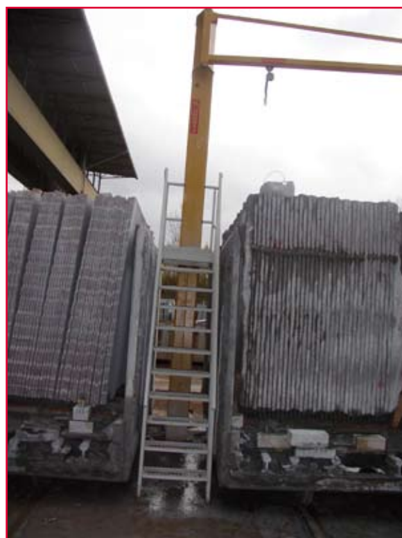
Foto 2 – Scala fissa a castello per l'accesso alla sommità delle lastre e dispositivo retrattile applicato a braccio girevole.
